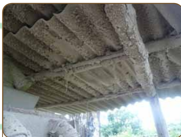
Figura 31: Área externa da fábrica suja.
