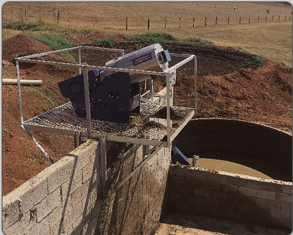
Figura 63 – Conjunto separador de sólidos instalado em plataforma.
