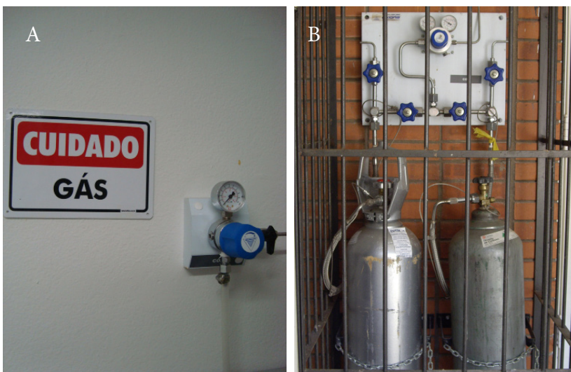
Figura 3. A) Adaptadores para gás O 2 e CO 2 ; B) Cilindros localizados na área externa do Biotério
